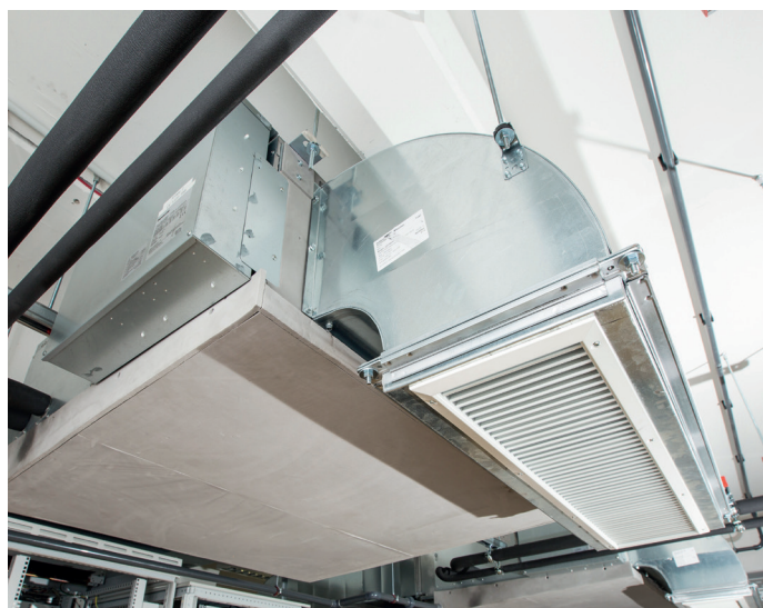
Effiziente IT-Klimatisierung mit Kanalgeräten in Kombination mit extra gefertigten Luftauslässen.
