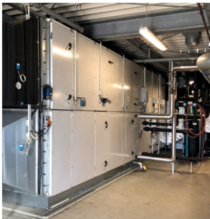
Anschluss der Kaltwassersätze an die Lüftungsanlage
