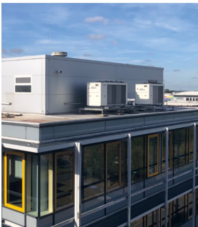
Die auf dem Gebäudedach aufgestellten Galletti-Maschinen
